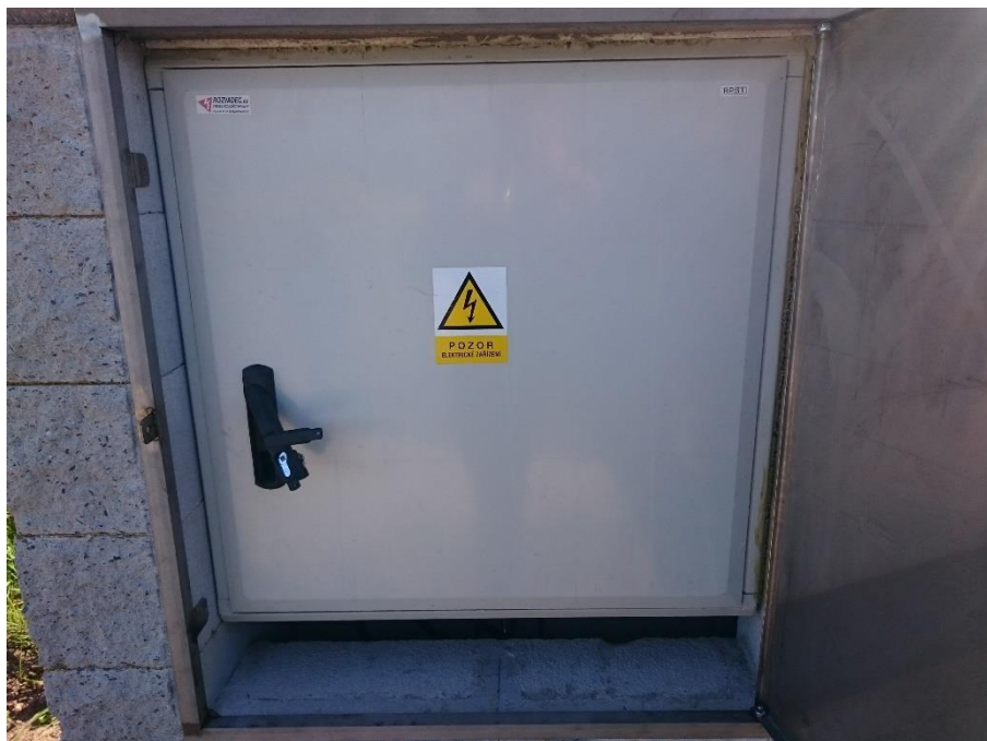
Obrázek 41: Rozvaděč s tříbodovým zámkem na klikku umístěn za hlavními dveřmi z nerezového plechu.
